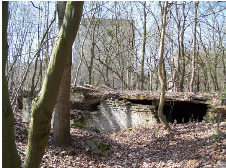
Abb. 26: Trafobaus Ruine, September 2008
