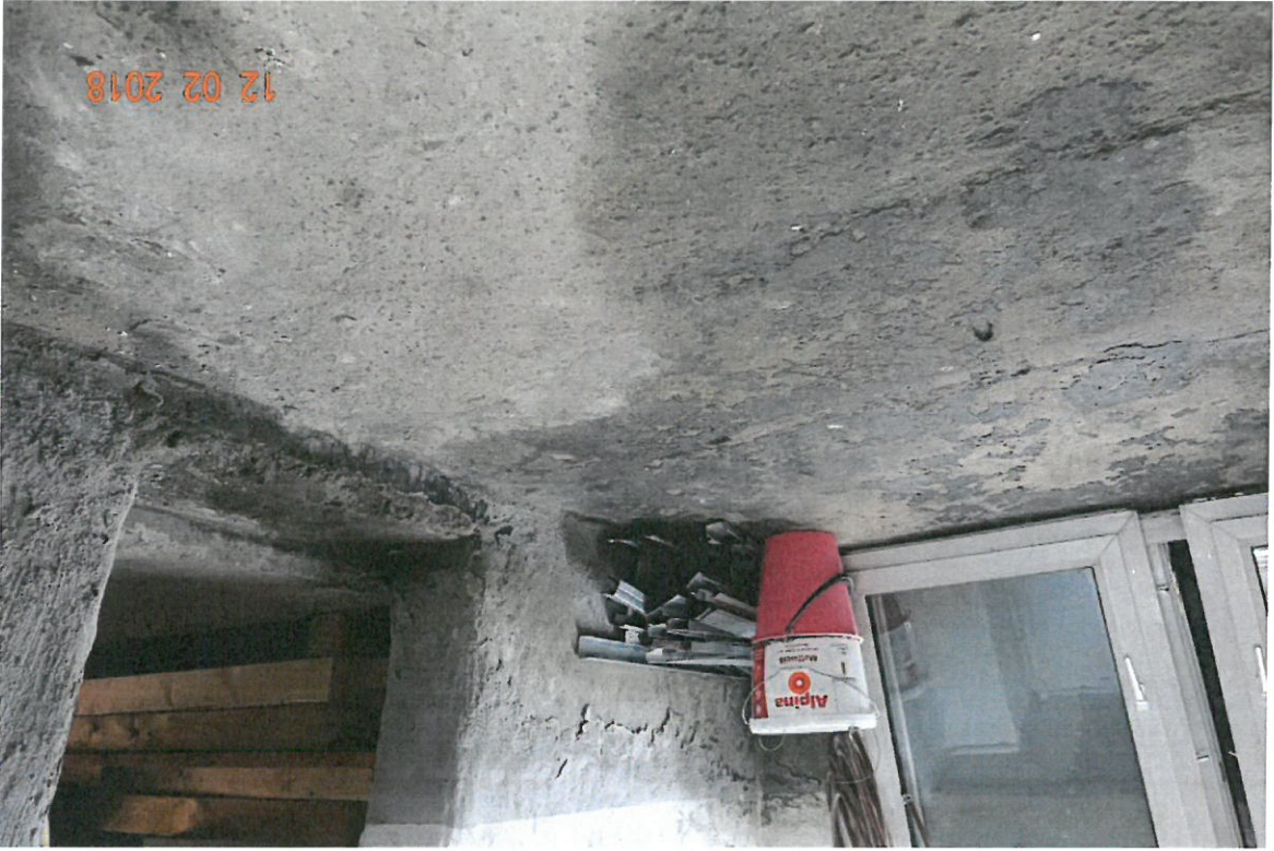
Bild 18: Wiesenstraße 9, Keller, mit Feuchteschäden im Wand und Fußbodenbereich
