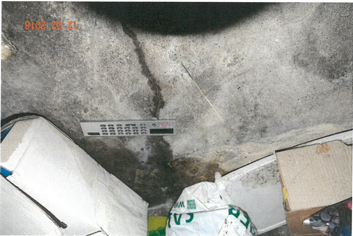
Bild 23: Wiesenstraße 15, Keller, nässender Riss im Kellerfußboden
