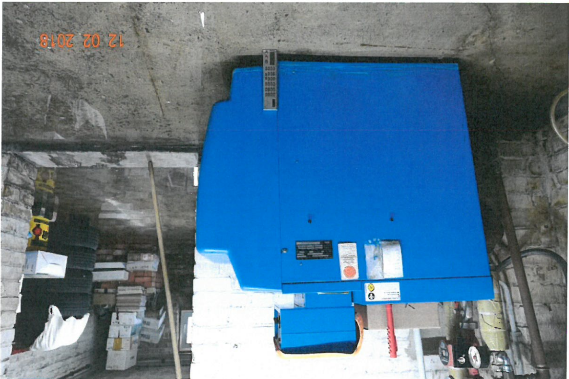
Bild 13: Wiesenstraße 7, Heizungskeller, vollflächig 1-2 cm unter Wasser
