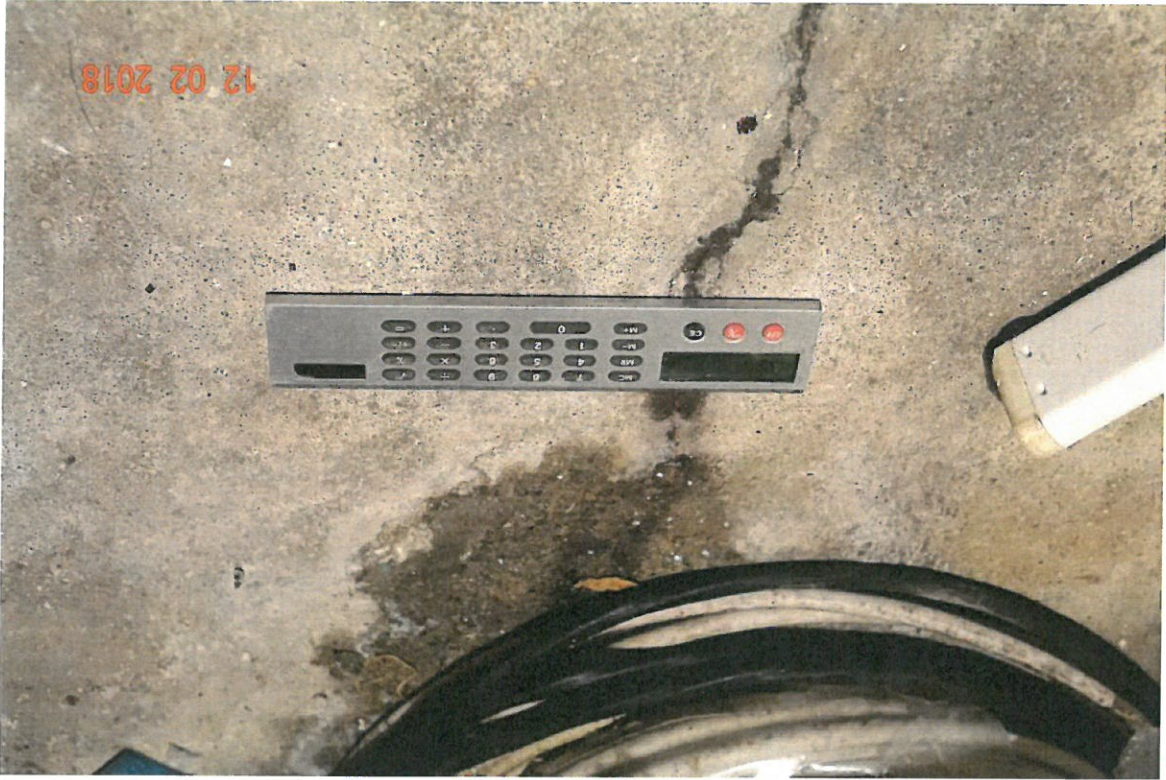
Bild 24: Wiesenstraße 15, Kellerflur, nässender Riss im Kellerfußboden
