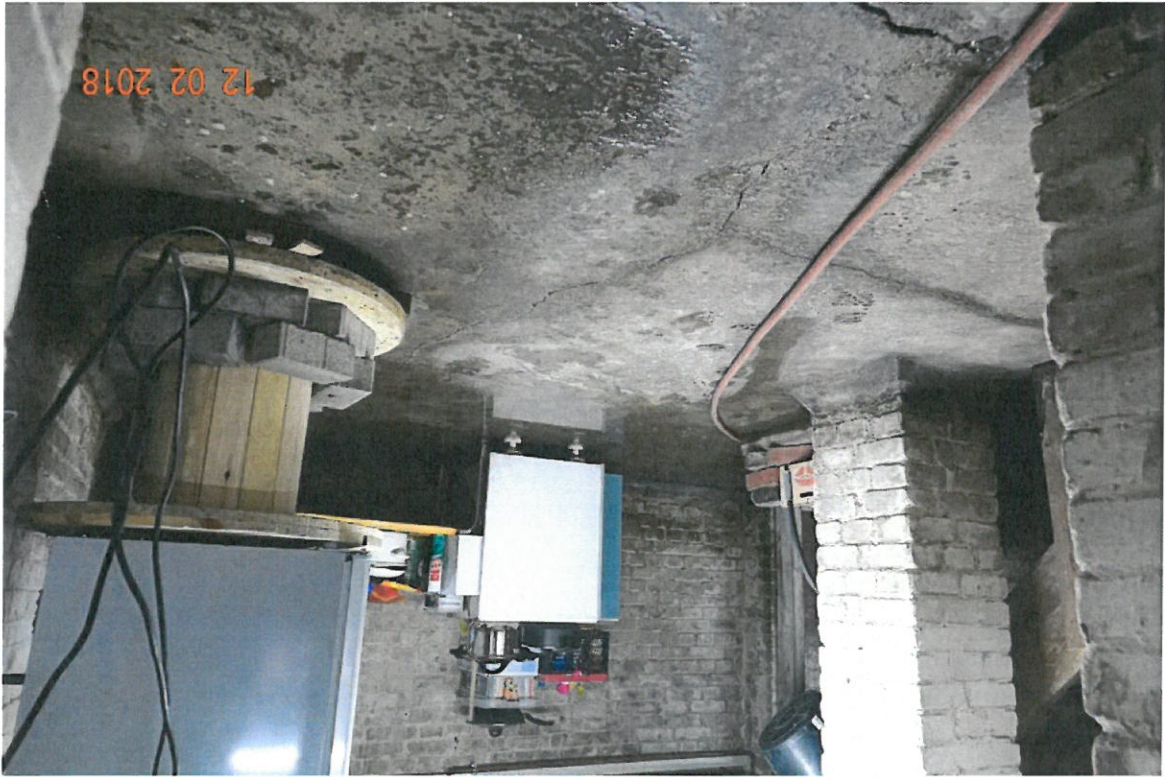
Bild 11: Wiesenstrasse 7, Kellervorraum mit aufgeständertem Kühlschrank und Wasserlächen
