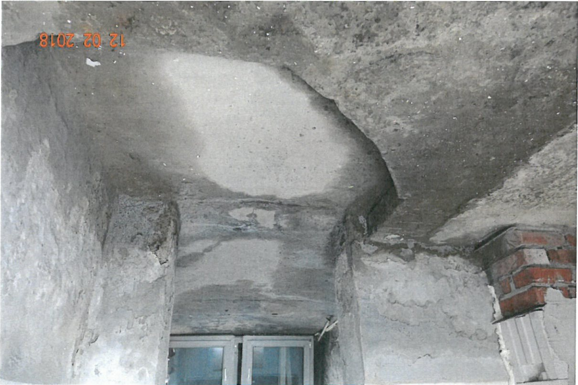
Bild 17: Wiesenstraße 9, Keller, mit Feuchteschäden im Wand und Fußbodenbereich
