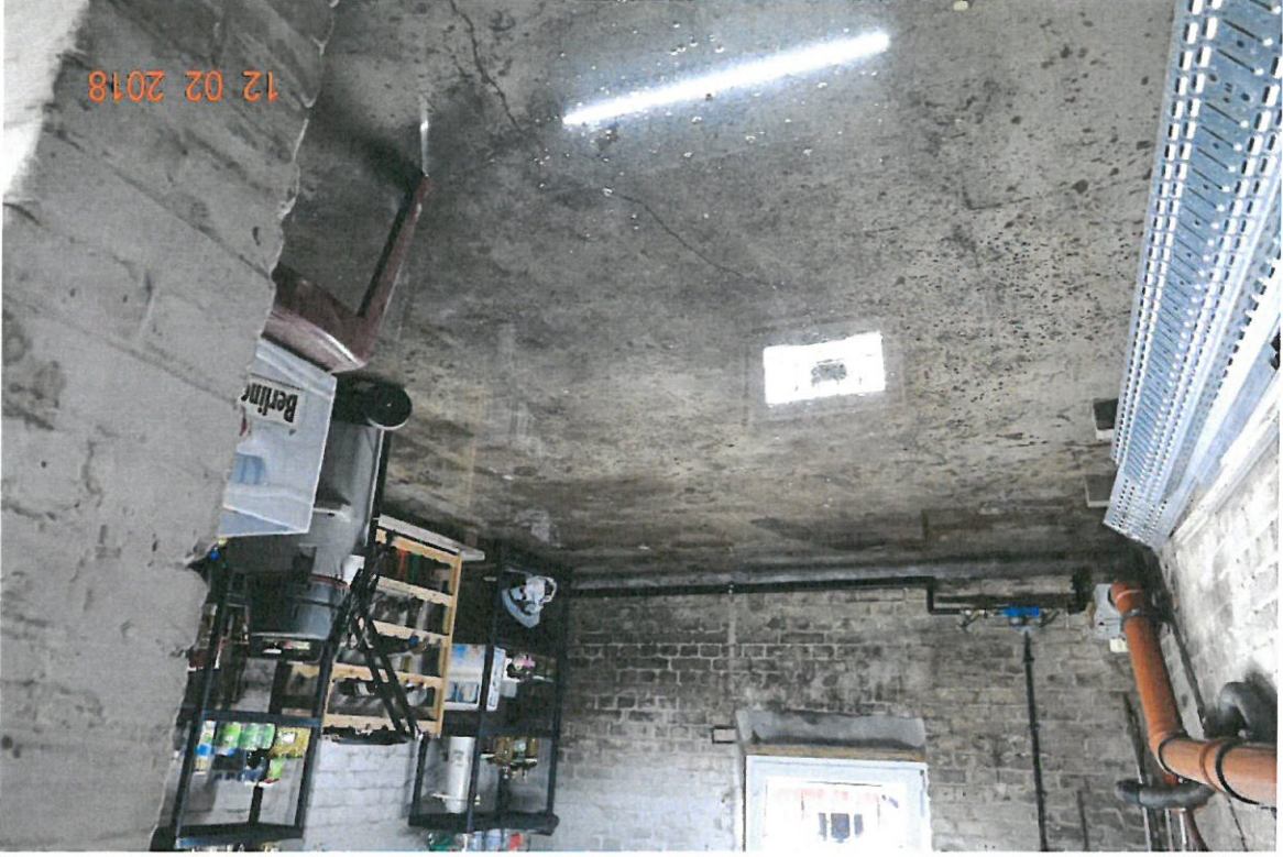
Bild 12: Wiesenstrasse 7, Keller, Vorratsraum vollflächig 1-3 cm unter Wasser
