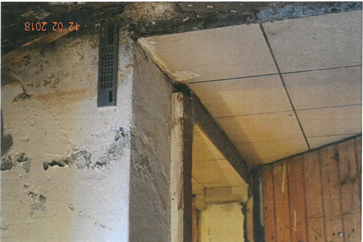
Bild 19: Wiesenstrasse 11, Heizungskeller mit Feuchteschäden an der Wand
