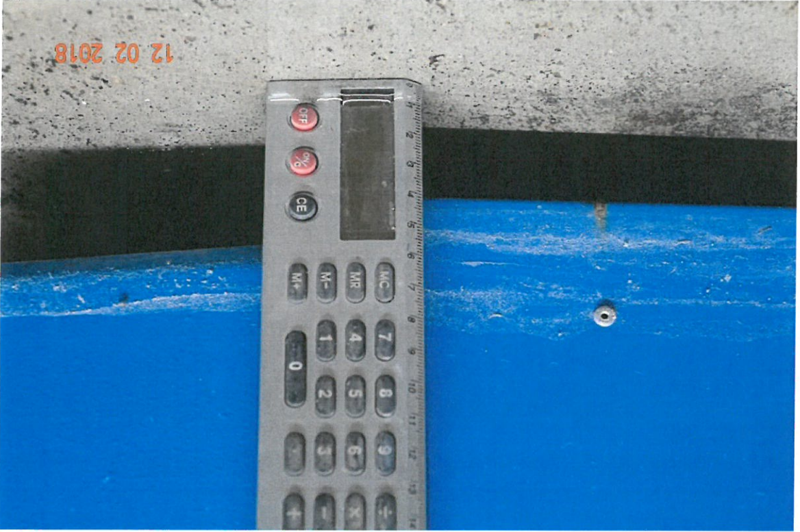
Bild 14: Wiesenstraße 7, Keller, Heizkessel, Detail mit Wasserrändern bis >8 cm über OK Fußboden
